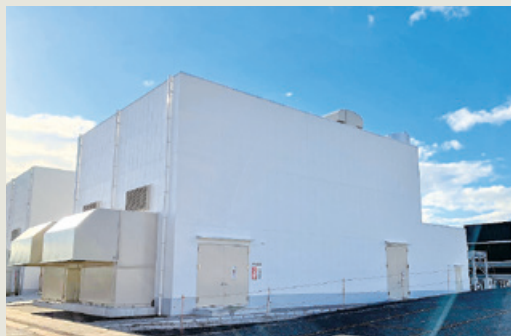
増設したガスエンジン発電設備
