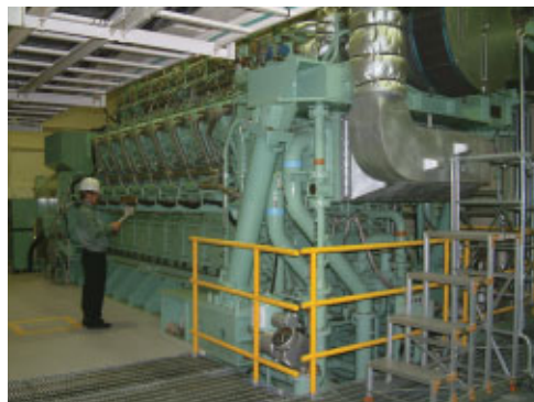
5,100kWガスエンジン
