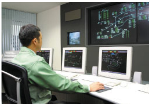
コントロール室
