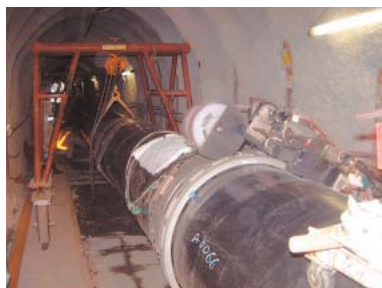
トンネル内の配管
