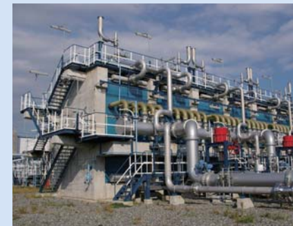
LNG気化器…マイナス162℃のLNGに海水をかけ、天然ガスに気化する装置
