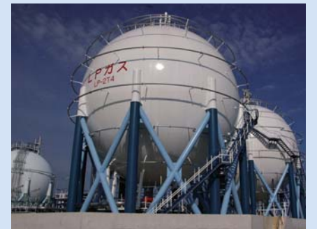
LPGタンク…気化した天然ガスにLPGを加え、所定の熱量に調整します
