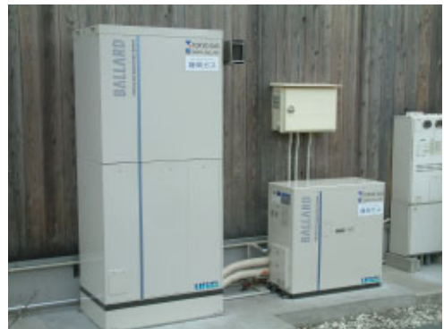
お客さま宅に設置された燃料電池「ライフエル」
