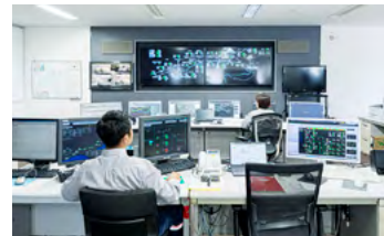
主要ガス導管の遠隔監視システム
